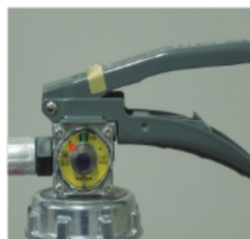
× 安全栓の脱落
