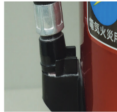
× 消火薬剤の漏れ
