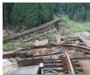
豪雨被害を受けた鉄橋
