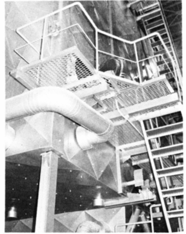
電気集じん機など 公害防止の機械が設置された
