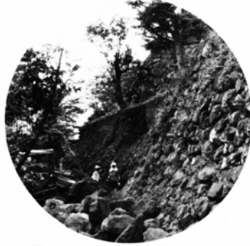
▲9月1日 約400年前から残っている越前大野城の石垣 のつち の補修工事が始まり、野面積み工法を守って積み直しされました。
