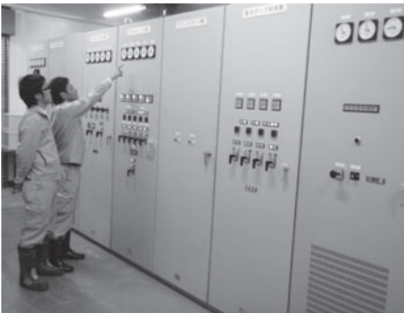
上水道配水機器の点検
