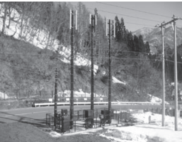
下半原の携帯電話基地局
