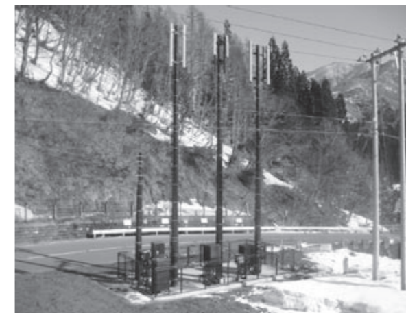
下半原の携帯電話基地局
