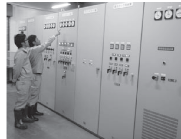
上水道配水機器の点検
