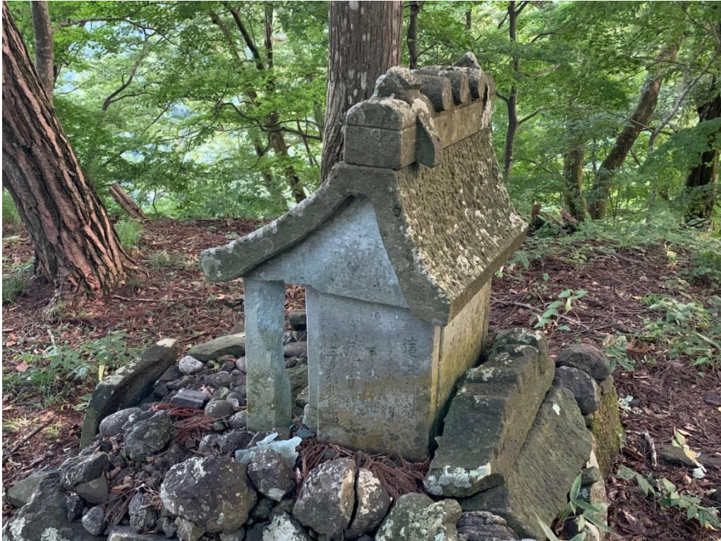
右向拝柱が破損
