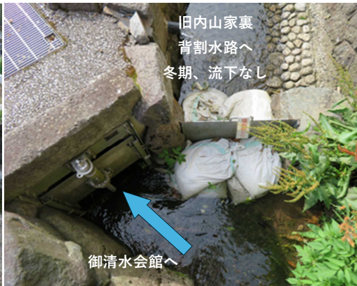
「羽二重伝習所跡」 止水板（2025年春から土嚢あり）
