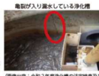
電線が入り漏水している浄化槽 (図像出典：令和2年度浄化槽の法定検査及び浄化槽整備促進に関する調査検討業務報告書)
