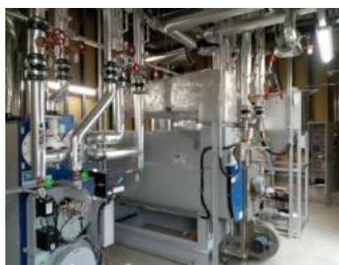
うらら館への木質バイオマスボイラー導入（令和5年度）
