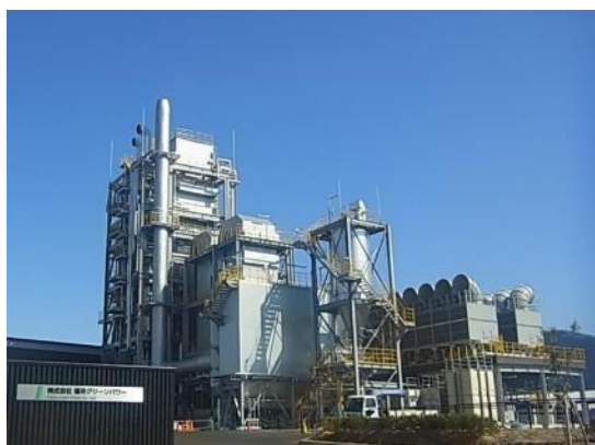
福井グリーンパワー大野発電所
