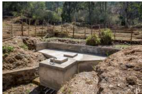
2018年撮影 水源地の給水施設のタンク
