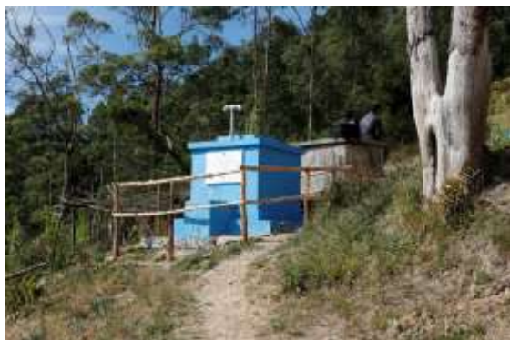
2017年撮影 水源地のタンク
