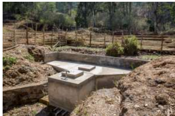
2018年撮影 水源地の給水施設のタンク
