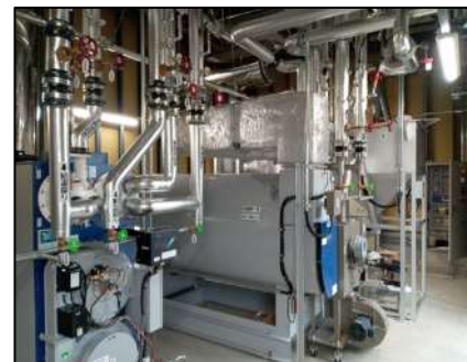
トロン温浴施設「うらら館」の 木質バイオマスボイラー
