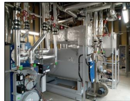
トロン温泉施設「うらら館」の木質バイオマスボイラ
