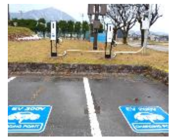
電気自動車充電設備 (エキサイト広場)
