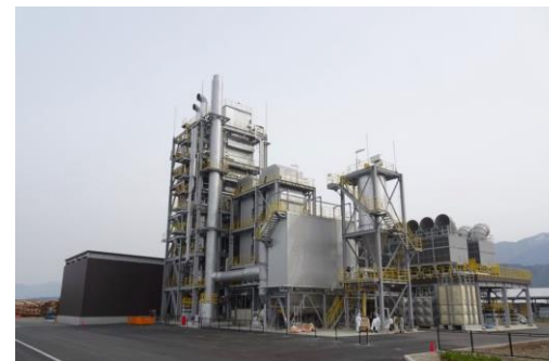
木質バイオマス発電所
