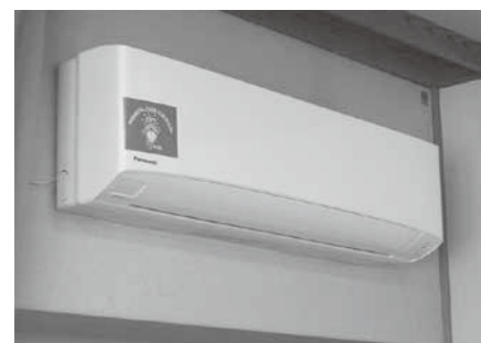
田野区 (エアコン)
