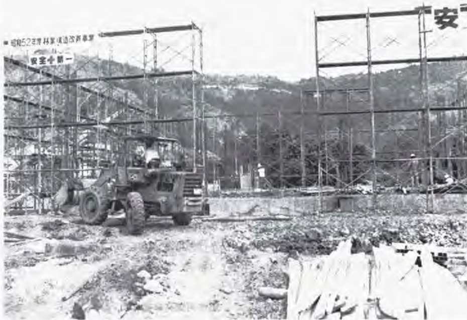
完 成 を め ぐ さ ず 大 野 市 林 業 振 興 セ ン タ ー 新 築 工 事 (宝 慶 寺)
