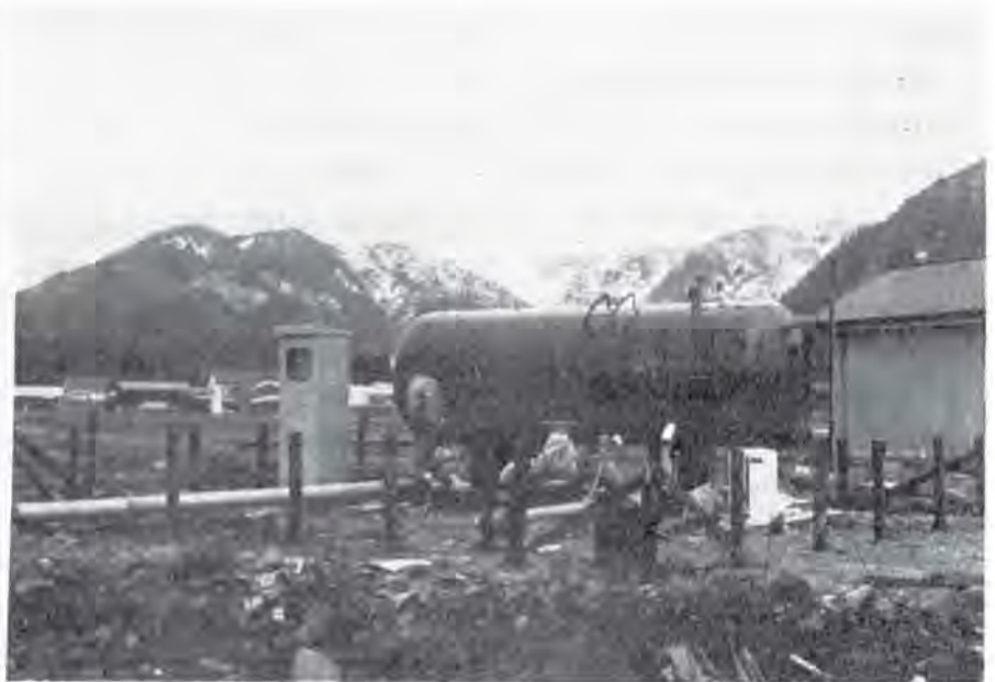
緊急給水用水源井(母子寮跡)
