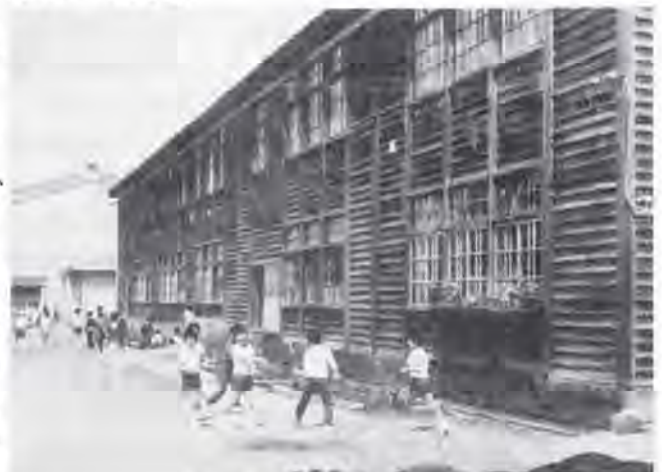
老朽化した下庄小学校
