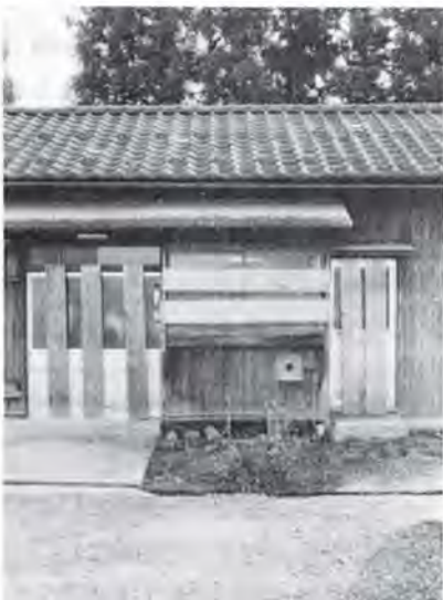
改造以来利用されていない身障者用住宅
