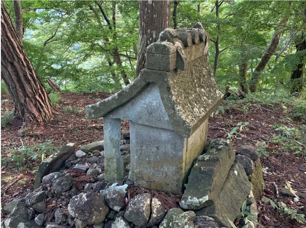
右向拝柱が破損
