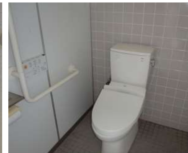
【洋式トイレ(乾式整備予定)】 ※嶺北特別支援学校導入事例
