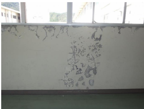
【廊下の塗装剥がれ】
