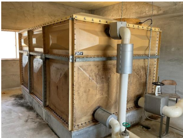
高架水槽 ・錆やカビが発生している
