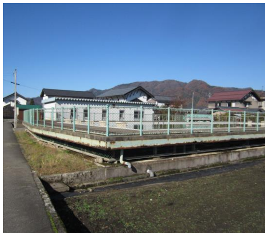
プール ・鉄骨部に腐食あり
