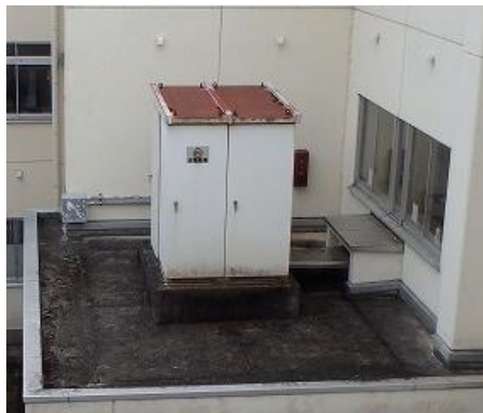
受変電設備 ・耐用年数30年が経過している
