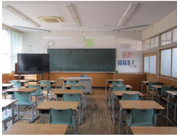
普通教室 ・老朽化した床 ・建設当初の木製間仕切
