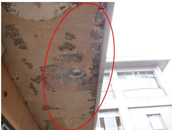
軒下 ・塗膜剥離、鉄筋の露出あり
