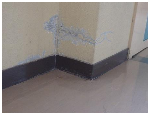
内壁 ・漏水による塗膜の剥離
