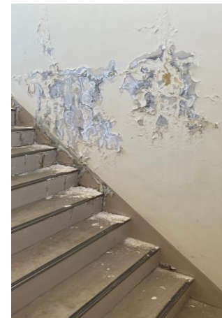
内壁 ・漏水による塗膜剥離
