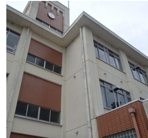
外壁 ・タイルの浮き
