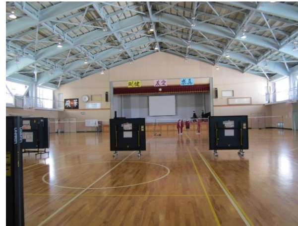
体育館 ・屋根からの雨漏りがあり
