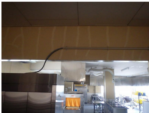
内壁 ・下がり壁のクラック
