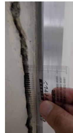
内壁 ・クラック
