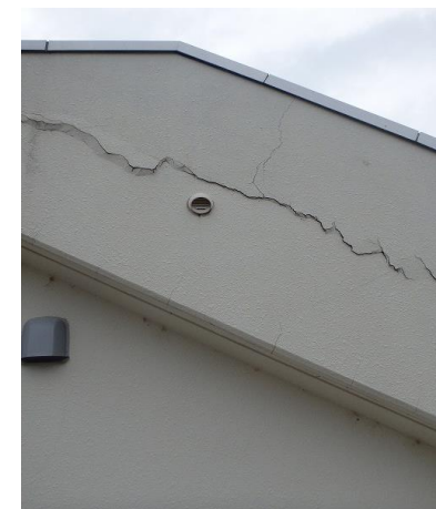
外壁 ・クラックと塗膜の剥離
