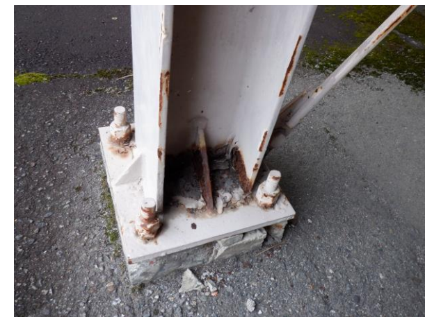
体育館の社会体育用出入口 ・鉄骨柱脚部の腐食あり
