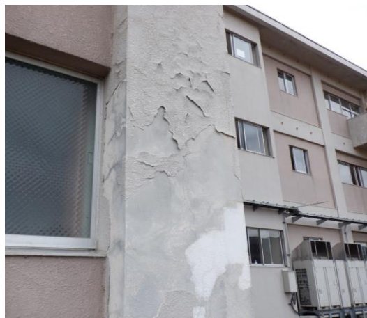
外壁 ・塗膜剥離
