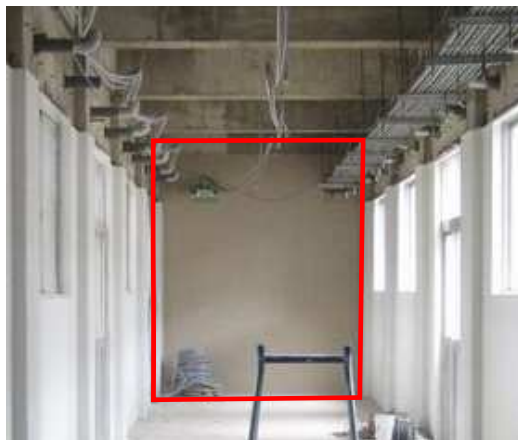
内部仮間仕切 廊下に、改修範囲を区分する間仕切壁を設置
