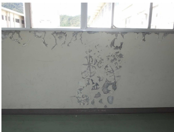
【廊下の塗装剥がれ】
