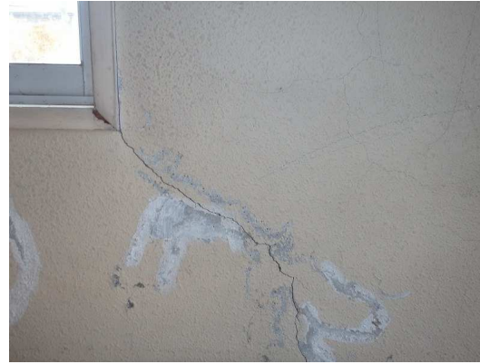
内壁 ・クラックがある
