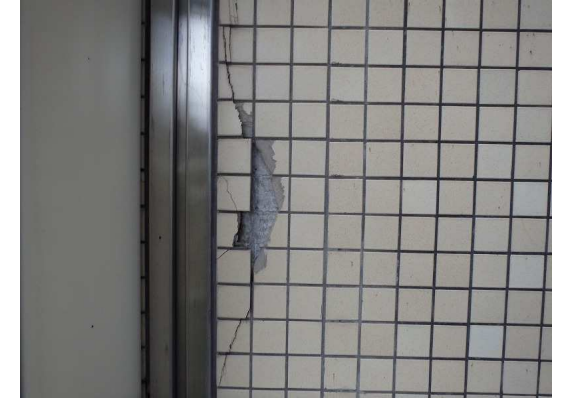
外壁 ・タイルの浮きやクラックがある
