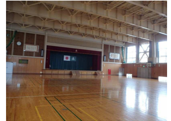
体育館 ・一部暗幕の不具合 アリーナはLED照明改修済み
