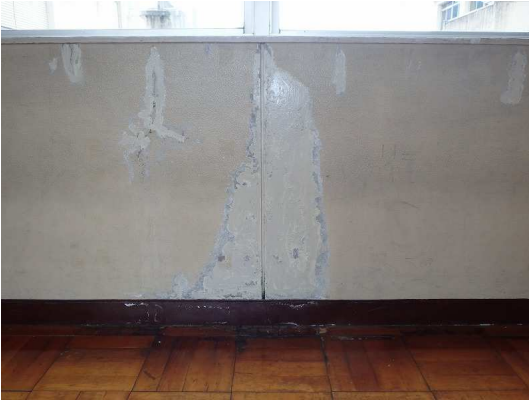
内壁 ・漏水による内装塗膜の剥離多数
