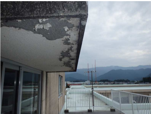
校舎軒下 ・塗膜剥離、鉄筋の露出あり
