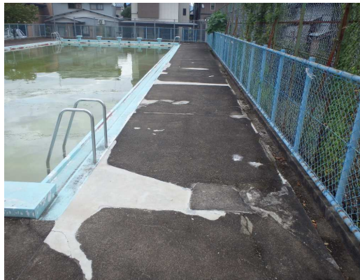
プール ・プールサイドのモルタル剥離
