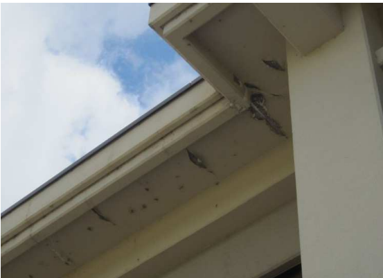
校舎軒下 ・塗膜剥離あり
