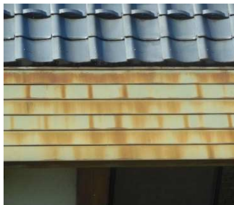
ランフォーム棟 ・屋根が一部錆ている
