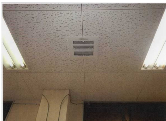
整備した換気扇
