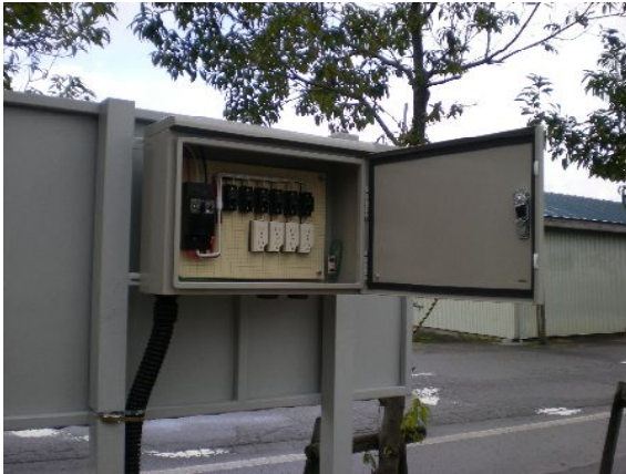
写真6 看板に取り付けられた配電盤
