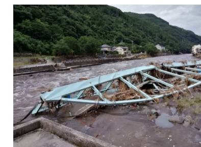
令和2年7月豪雨 大分県日田市の流された橋
