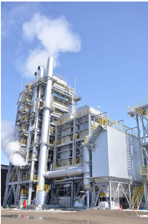
木質バイオマス発電所
