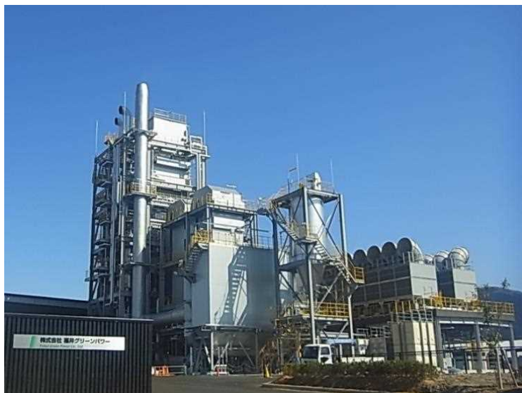
市内の木質バイオマス発電所
