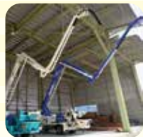
圧送ステーション
