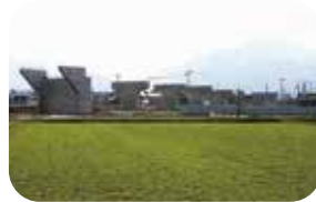
永平寺大野道路中津川高架橋 下部工事(橋台・橋脚工事)
