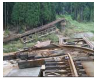
豪雨被害を受けた鉄橋
